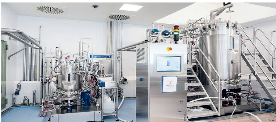
Abb. 1: Die neue Fermentieranlage
